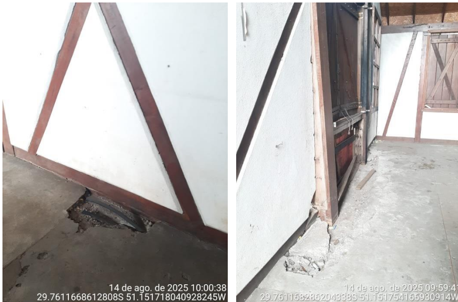
Figura 08 e 09: Contrapiso deteriorado
