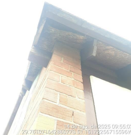
Figura 04: Forro OSB danificado em razão da umidade
