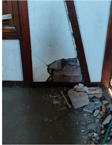
Figura 11: Trecho da parede a ser recuperado
