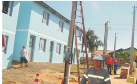
Instalação da rede elétrica na 1ª área de reassentamento do arroio Krusz. Fonte: PAC / Krusz.
