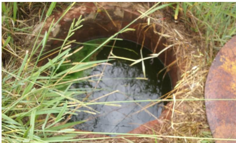
Figura 7 – PV entre a Lagoa Facultativa 3 e a de Maturação
