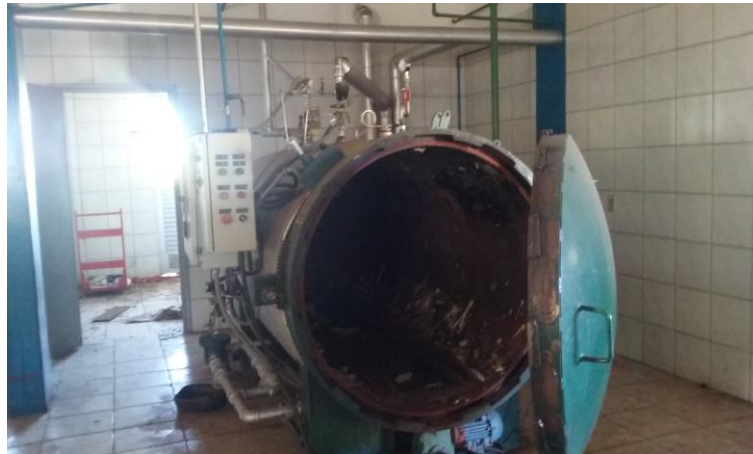
Figura 10 - Instalações do Sistema de Autoclavagem
