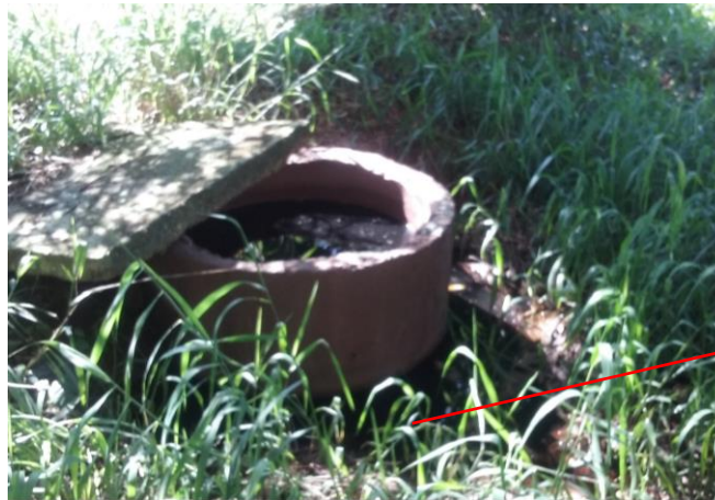
Figura 2 Caixa de passagem efluente bruto danificada
