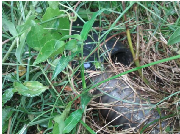
Figura 8 – Tubulação Recalque do Efluente
