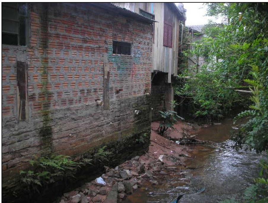
Figura III.62: Imagem da margem obstruída do Arroio Cerquinha, região Parque Sinuelo depositados no Arroio Cerquinha, região Santo Augusto. Fonte: SEPLAN/PAC, 2010.
